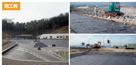
左:釣堀池 右上:路盤砕石と上部コンクリート舗装の分離 右下:雨水貯留槽
