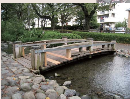
改修前(天然木が腐っている)
