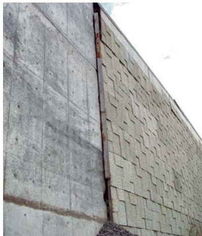
写真-1 被災後の状況
