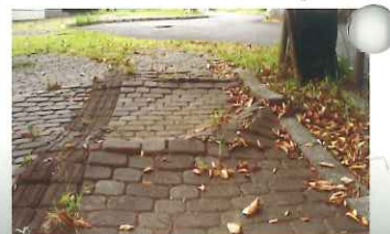
樹木の根による路盤の持ち上がり
